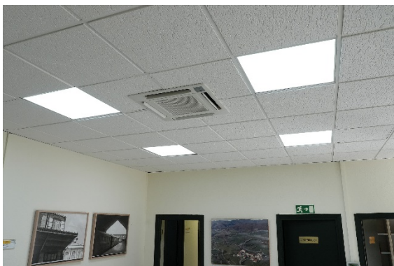
Luminarias LED en pasillo
