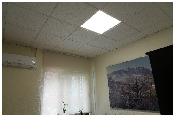
Luminaria LED en despacho
