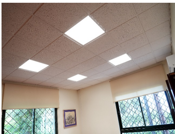
Luminarias LED en Sala de reuniones
