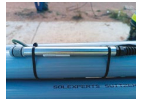
Piezómetro de cuerda vibrante adosado por el exterior de la tubería de auscultación inclinométrica de un sondeo
