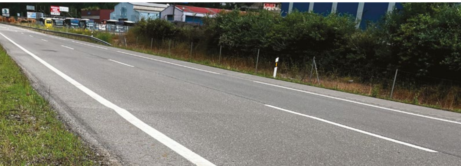
Patología observada. Abombamientos.
