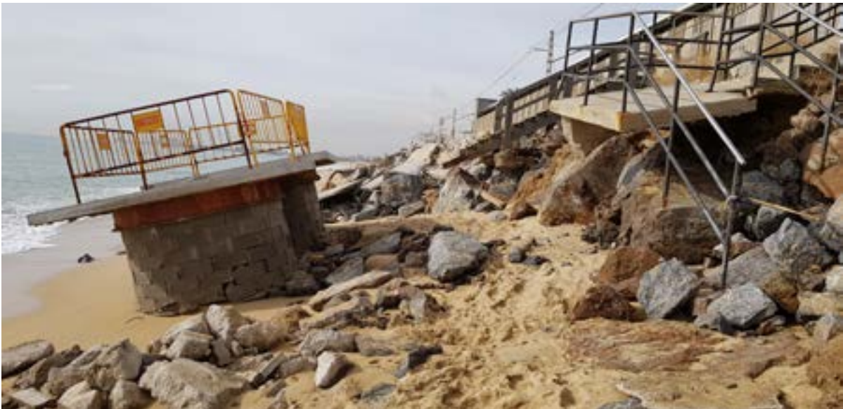
Vista de la erosión de la playa y destrucción del muro costero en Montgat (Barcelona) después del paso de la borrasca Gloria
