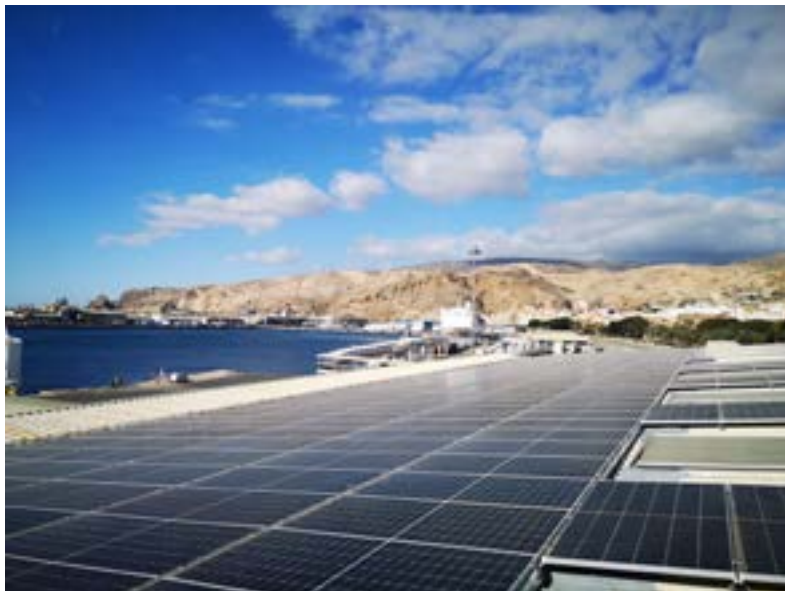
Instalación fotovoltaica instalada en la cubierta de la Estación Marítima del Puerto de Almería
