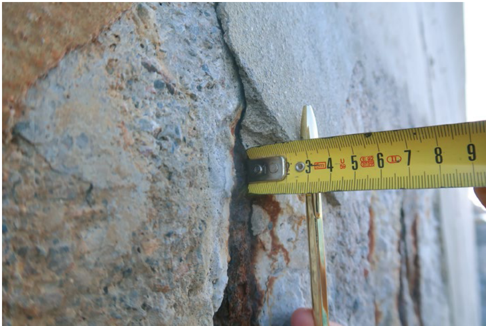
Corrosión avanzada por falta de recubrimiento
