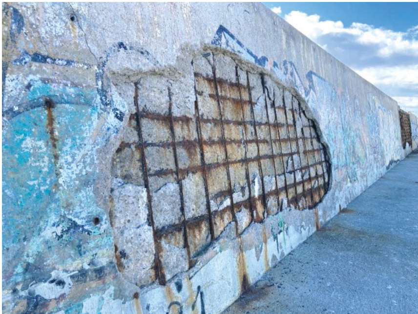
Daños típicos en estructuras costeras
