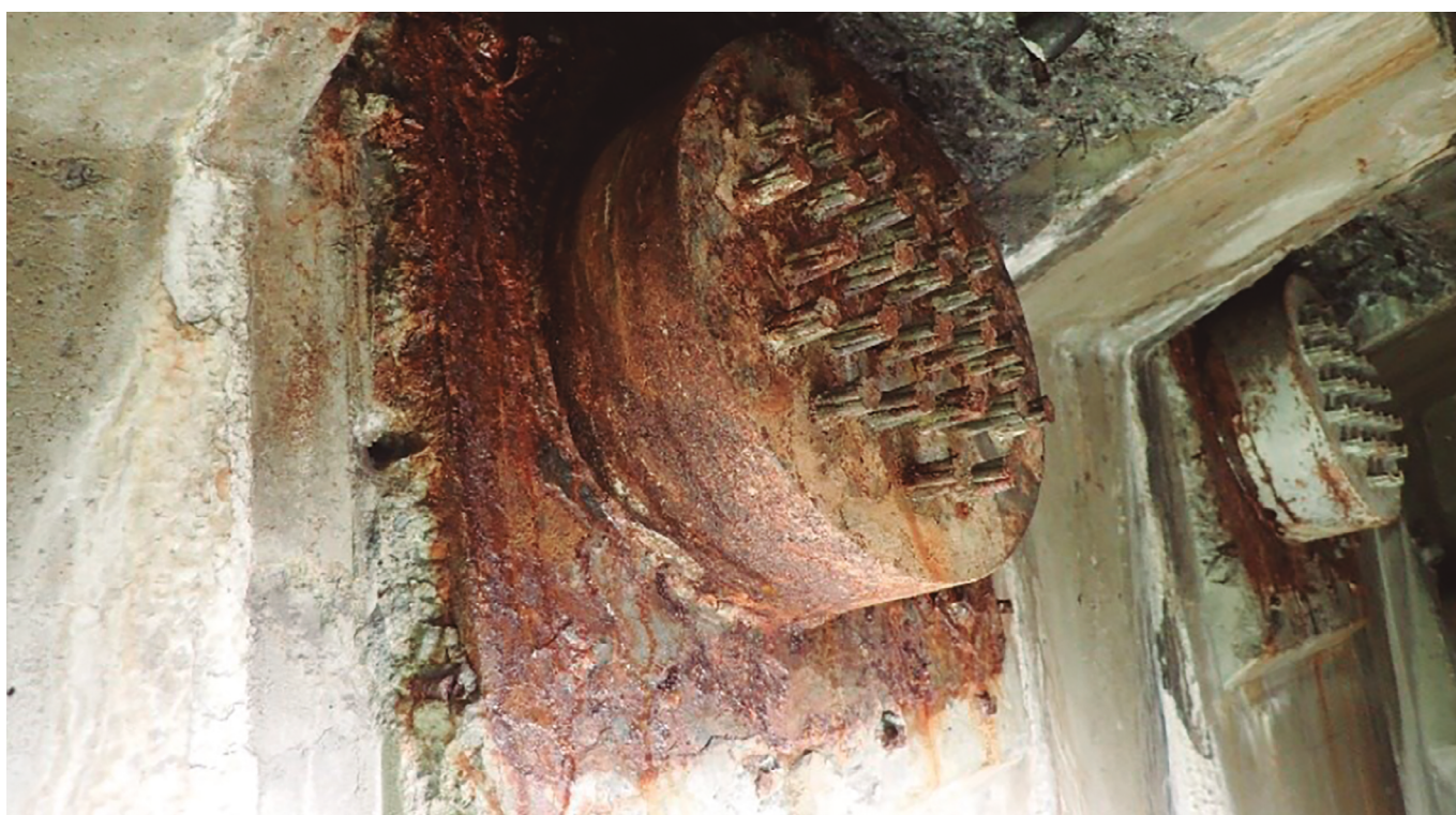
Cabeza de anclaje de un tendón de postesado con corrosión
